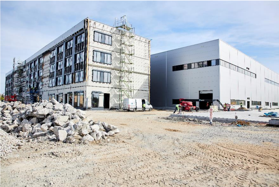
Bildunterschrift: AKASOLs neue Gigafactory 1, die am Headquarter im Südwesten Darmstadts entsteht, wird über eine Gesamtkapazität von bis zu 5 GWh verfügen.
